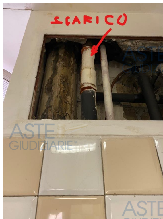
Foto 3 Scarico condominiale acque nere
